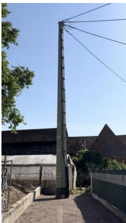
Der neue zentrale Ortsnetzmast in Kandel
